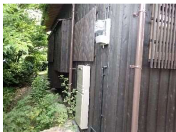
景観に配慮した配管の色
