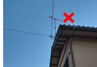
テレビアンテナの屋上設置
