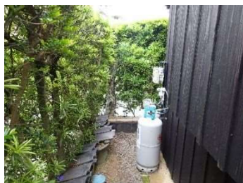
ガスポンプは見えない位置に設置
