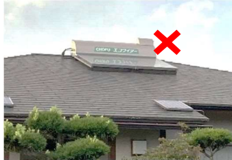
温水器設備の設置
