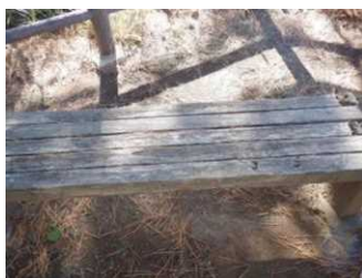
破損しているベンチ
