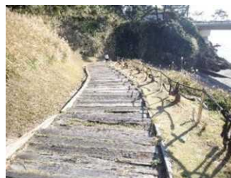
腐朽している外柵や階段
