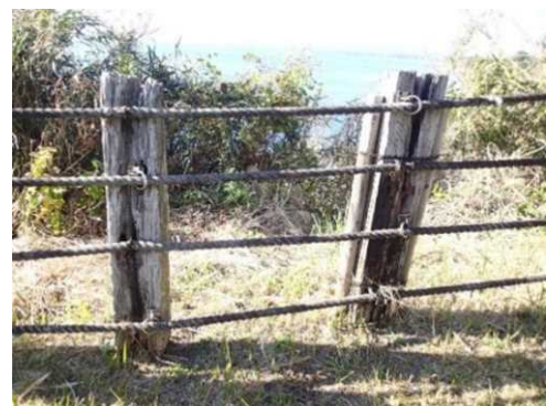
腐朽している転落防止柵
