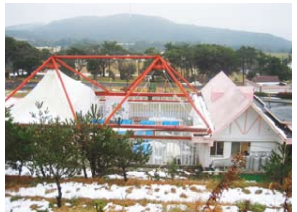
大雪の被害を受けたアグリランドえい
