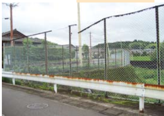
老朽化した調整池のフェンス
