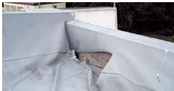
穎娃庁舎屋上の防水シート破損箇所
