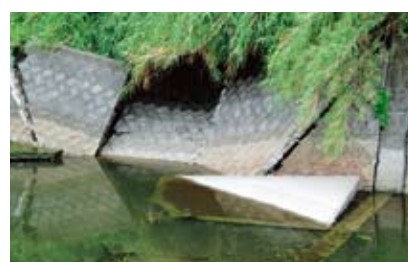
大雨により崩壊した護岸
