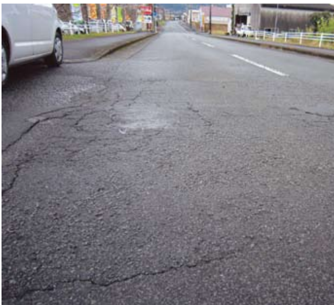
ひび割れが目立つ市道平山松崎線
