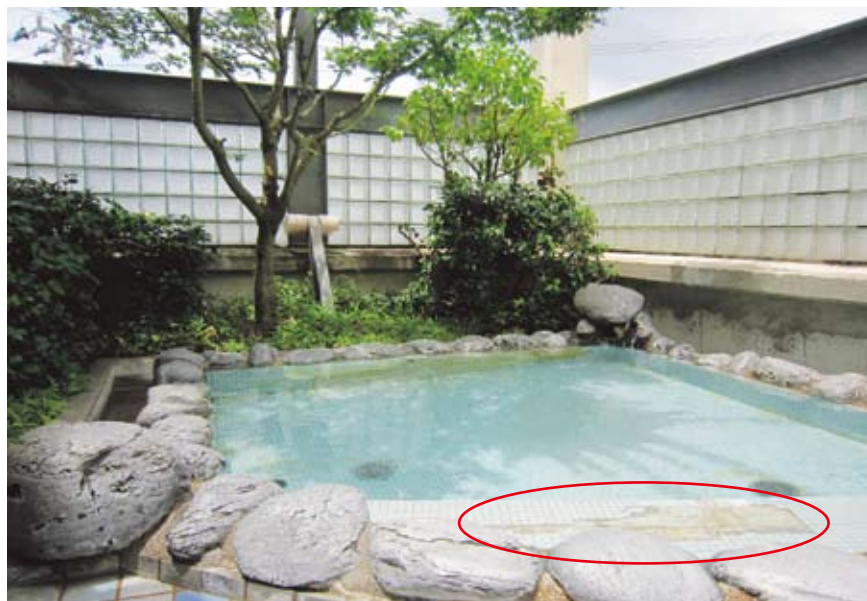
タイルの剥離が目立つ露天風呂（わくわく川辺）
