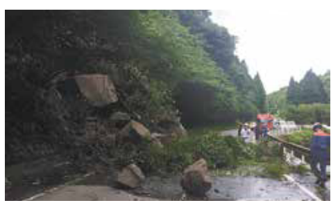
崩落直後の様子
