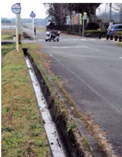
老朽化した用水路
