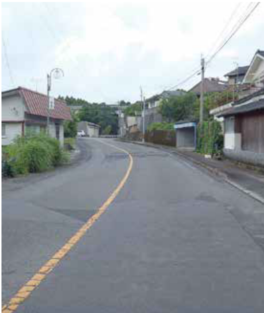
路面が劣化している県道（写真は県道石垣喜入線）
