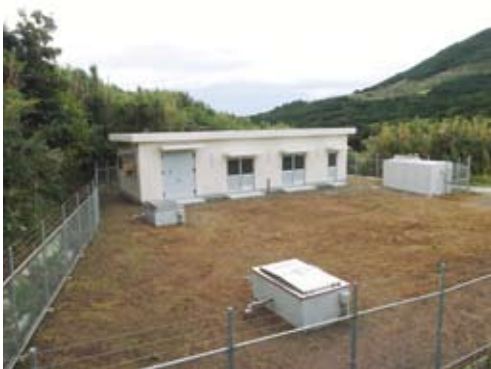
整備された嶽地区水源地
