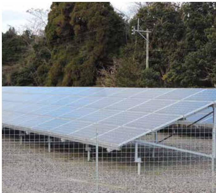
太陽光発電設備
