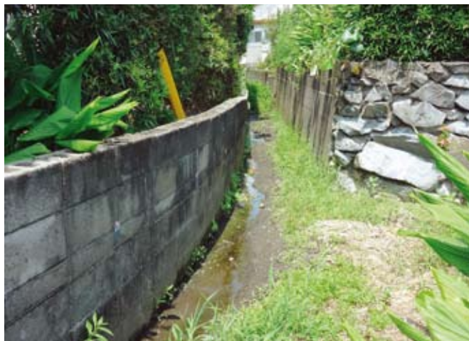
整備が待たれる排水路
