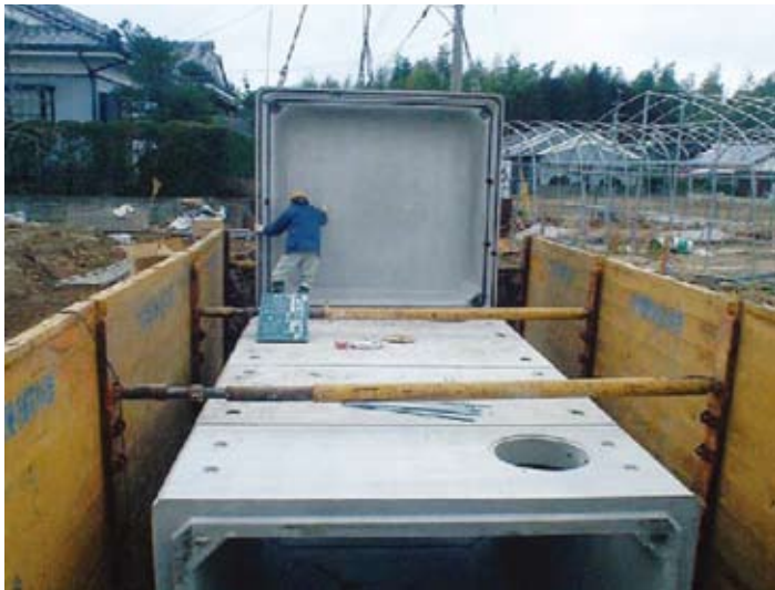
二次製品を利用した防火水槽
