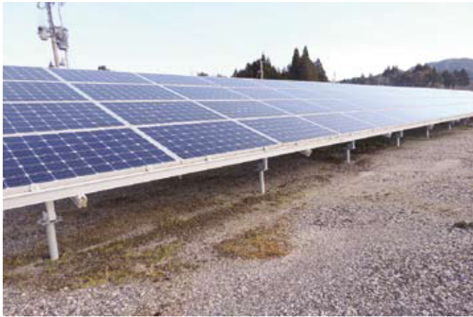
太陽光発電設備
