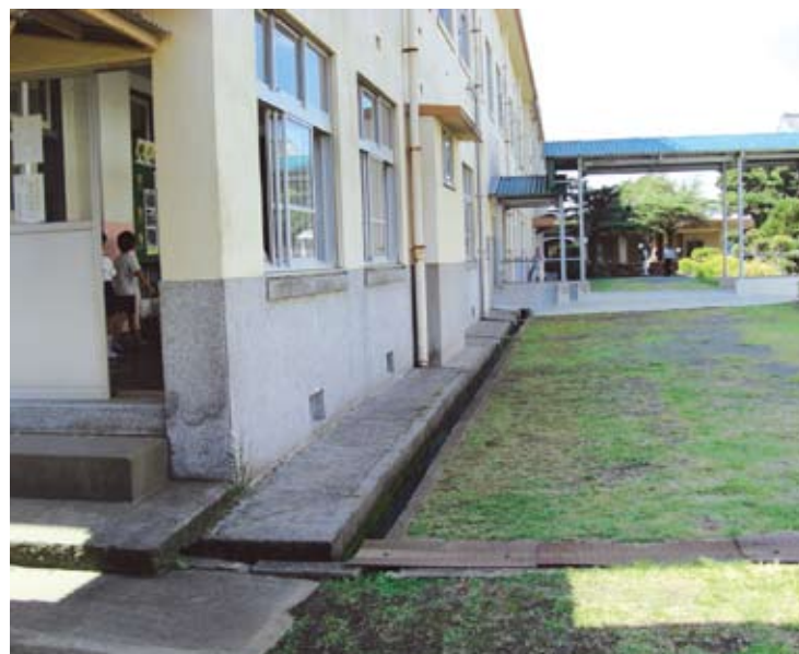
整備が待たれる側溝
