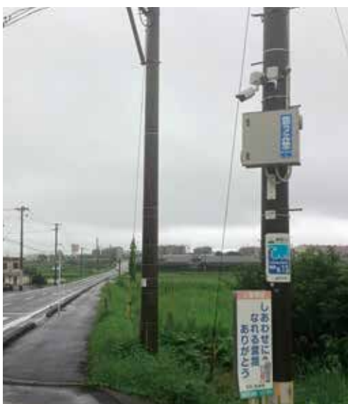
現在設置されている防犯カメラ
