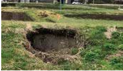
陥没した堤防（川辺町中山田）
