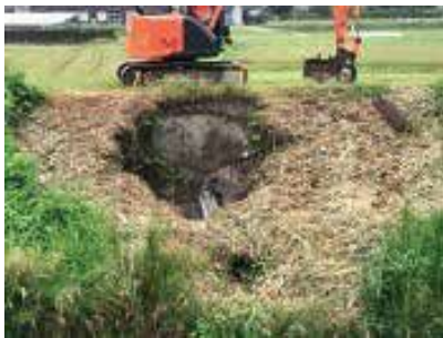
陥没の起因となる堤防内の工作物
