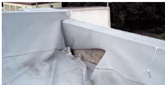
額娃庁舎屋上の防水シート破損箇所
