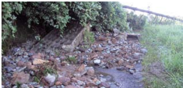
額娃地域二ツ山地区の災害現場
