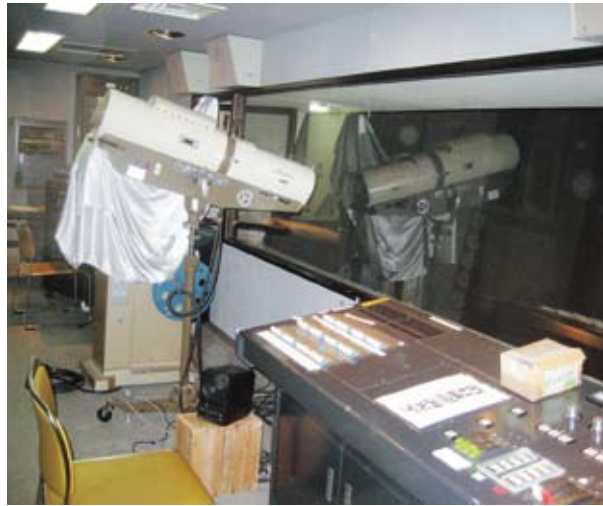
穎娃文化会館の照明操作室
