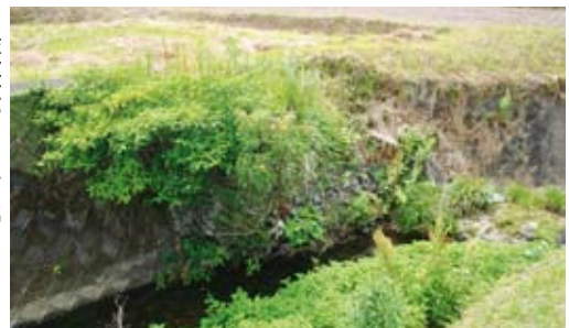
護岸が崩れた宮田川 （川辺地域）
