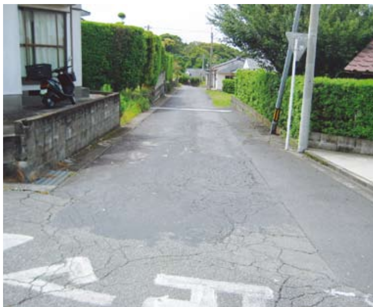
ひび割れが著しい東塩屋の市道塩屋線
