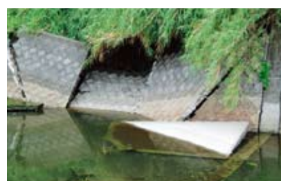
大雨により崩壊した護岸
