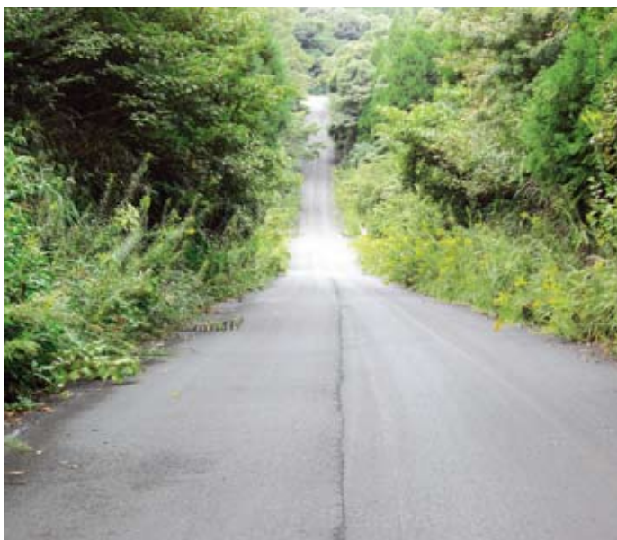
雑草が繁茂している空港道路
