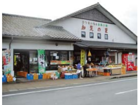
屋根の老朽化が著しい知覧の里
