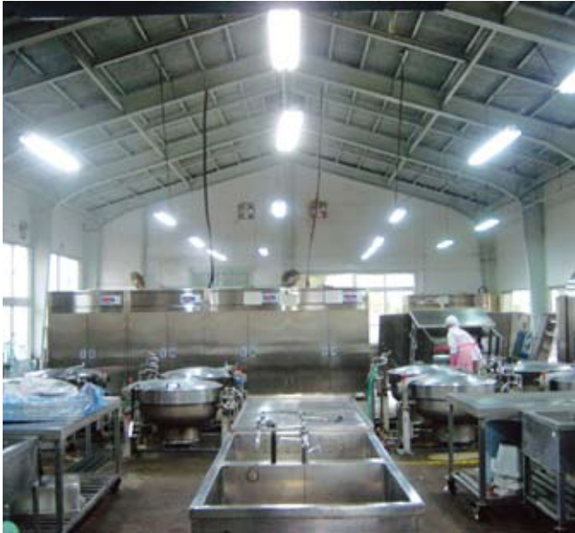
老朽化が進む給食センター
