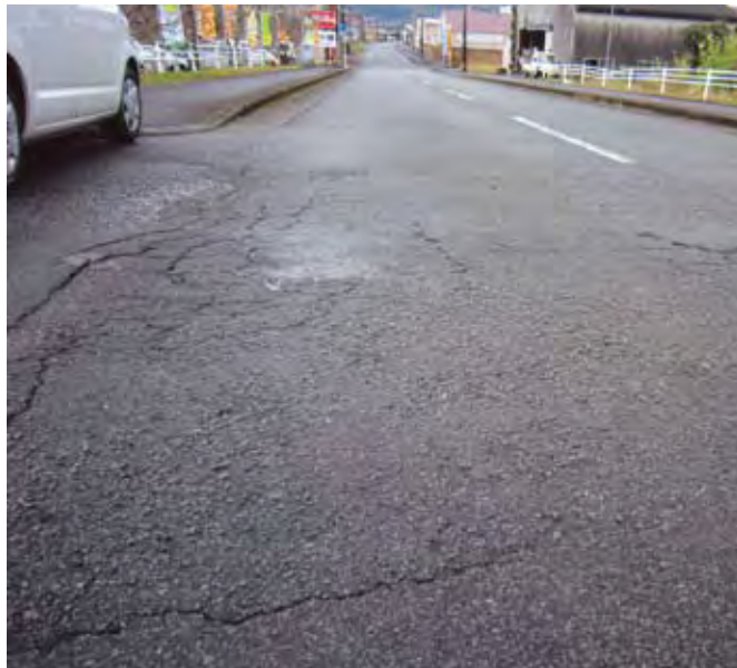
ひび割れが目立つ市道平山松崎線
