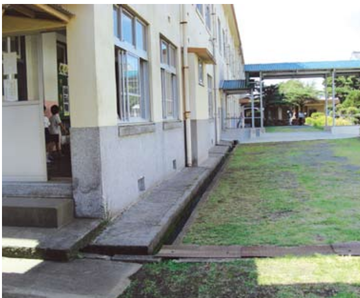
整備が待たれる側溝
