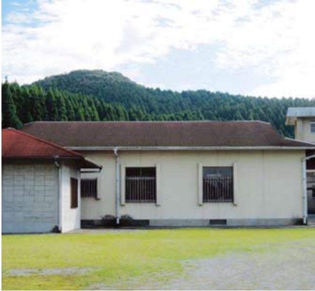
雨漏りがする川辺中弓道場
