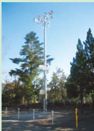
新設された屋外照明施設
