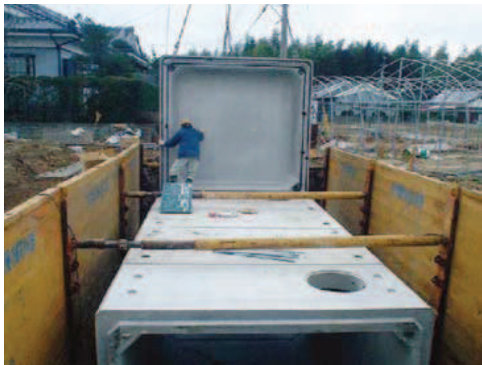
二次製品を利用した防火水槽
