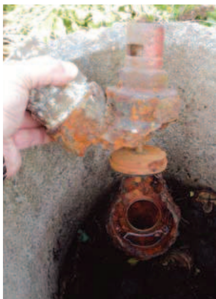
腐食した給水栓
