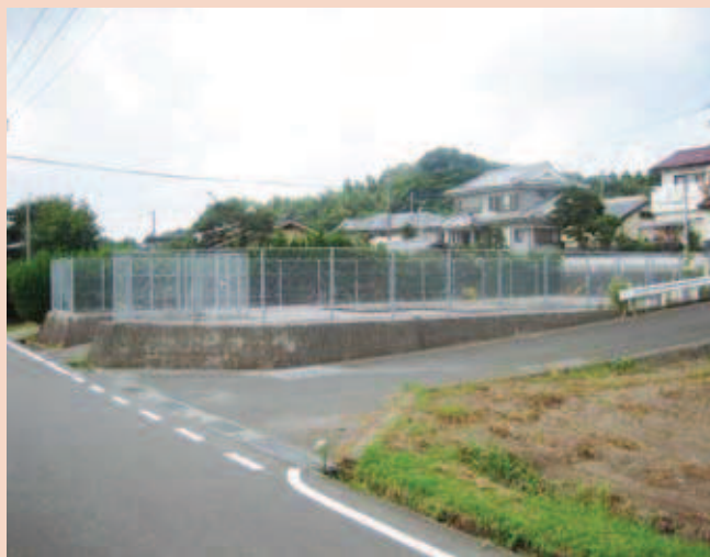
知覧みずほ団地合併処理浄化槽
