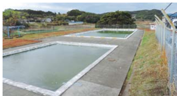
漏水のあった宮脇小学校プール
