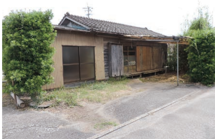
空き家となった住宅
