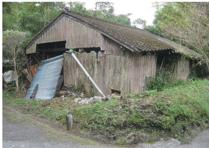
市道沿いの危険家屋
