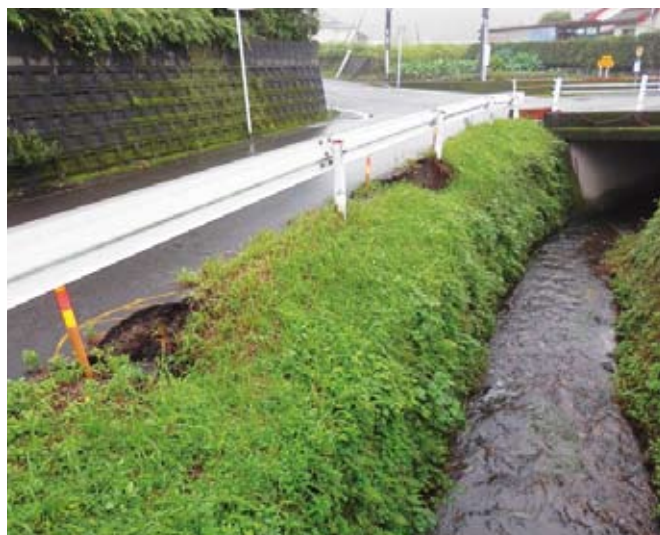
合同点検により確認された危険箇所
