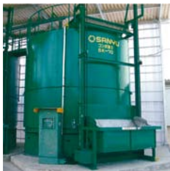
家畜排泄物堆肥化処理施設
