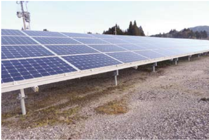
太陽光発電設備
