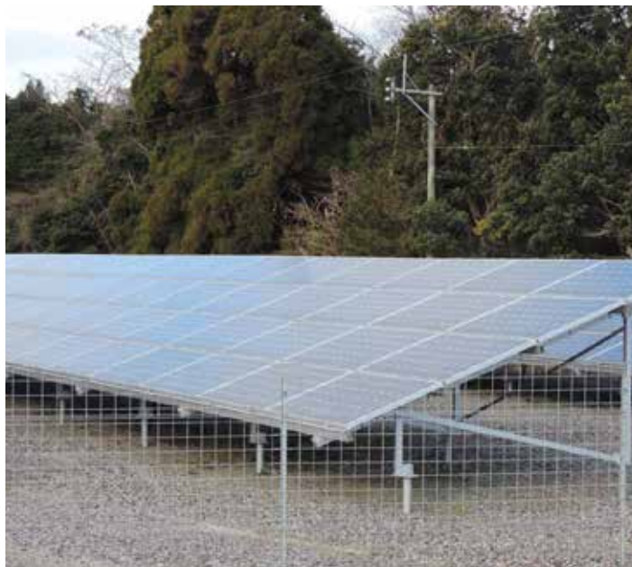
太陽光発電設備
