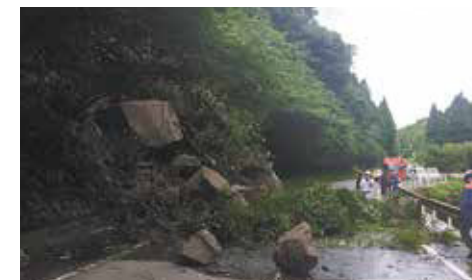
崩落直後の様子
