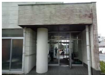
別館 外壁劣化
