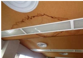
本館 雨漏り跡(3階)
