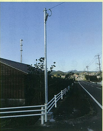
設置された防犯灯
