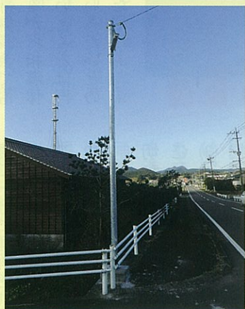
設置された防犯灯
