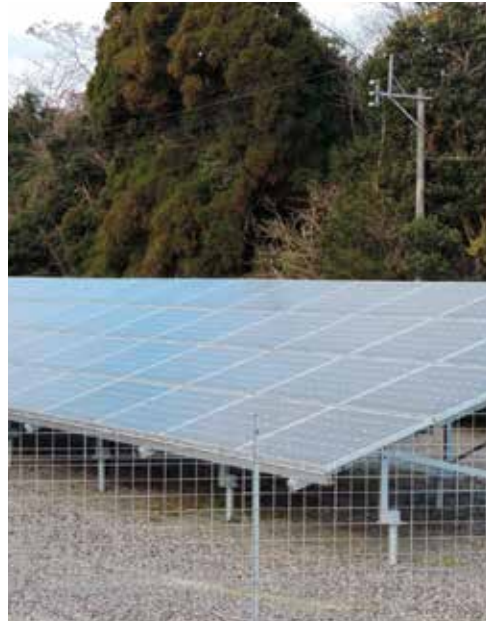
太陽光パネル
