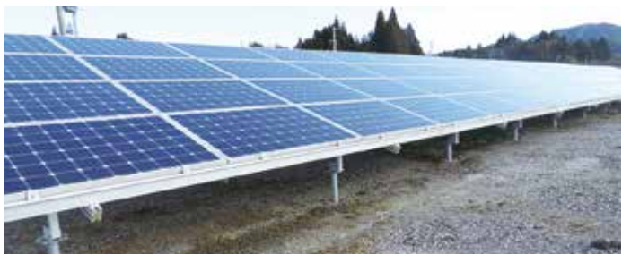
太陽光発電施設
