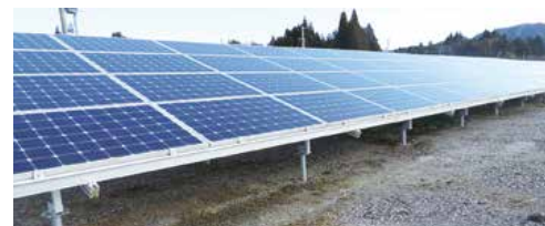
太陽光発電施設
