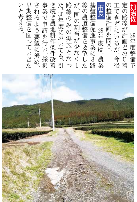
整備が必要な農道（折尾地区）
