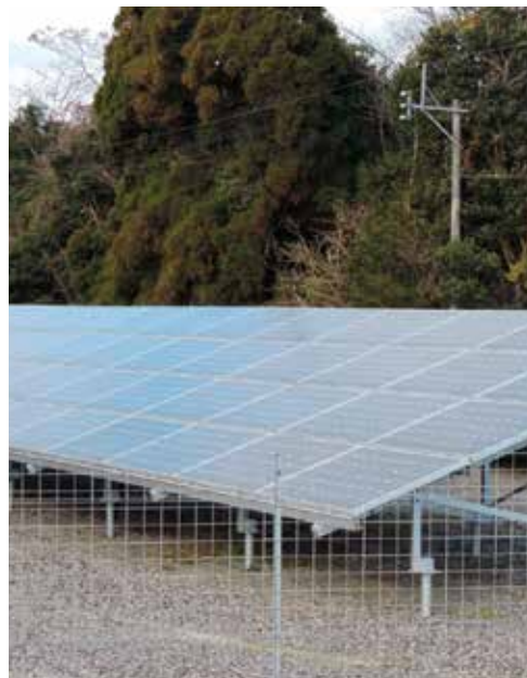
太陽光パネル
