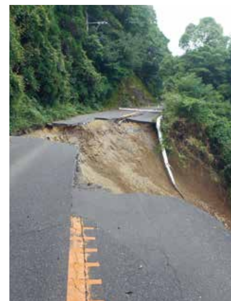
崩落した県道谷山知覧線
