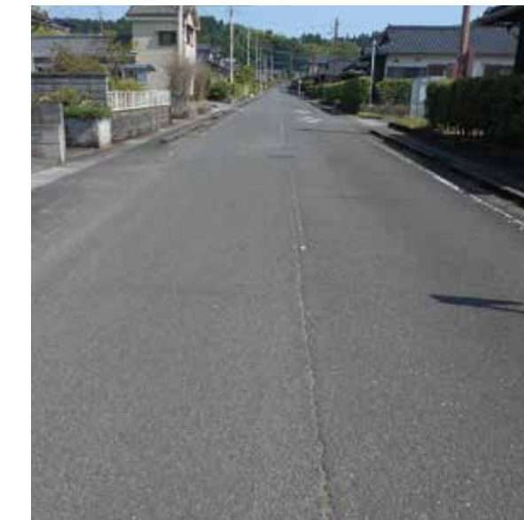
白線が消えかけている道路
