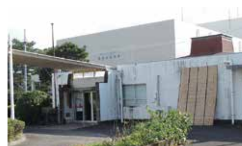
老朽化が進んでいる頼娃老人福祉センター
