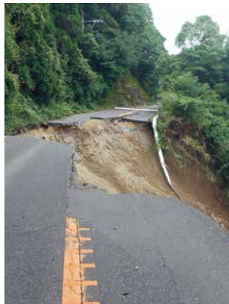
崩落した県道谷山知覧線
