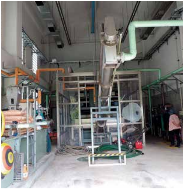
知覧中央浄化センターの終末処理場
