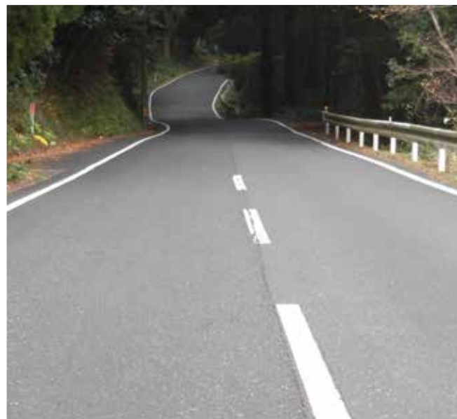
県道石垣加世田線（川辺町本別府地内旧長谷小付近）
