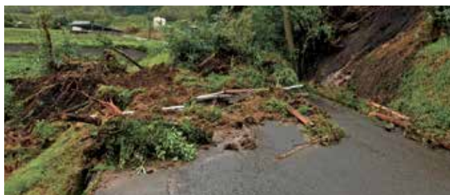
法面が崩れた市道
