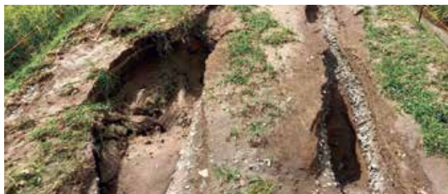
亀裂の入った農道
