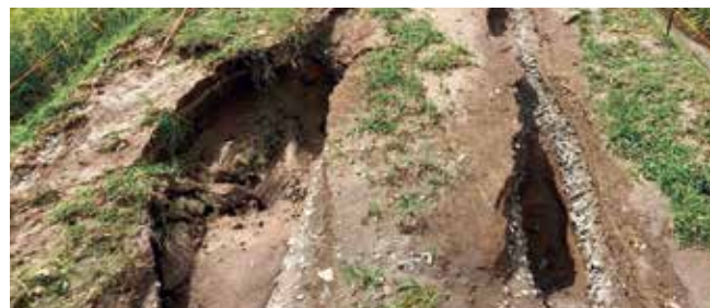
亀裂の入った農道
