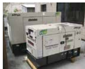
可搬型発電機
