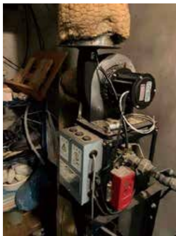
えい中央温泉センター サウナのボイラー
