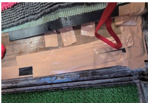
シロアリによる被害状況
