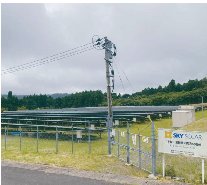
三本松工業団地（額娃）に設置の太陽光発電所
