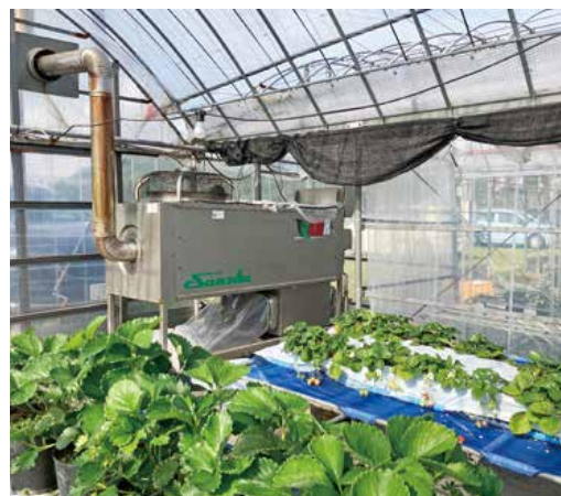
ハウス用ボイラー施設
