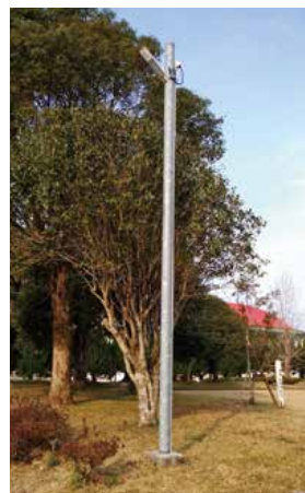
LED化された照明
