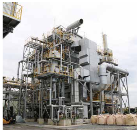
バイオマス発電所（枕崎バイオマスエナジー合同会社）
